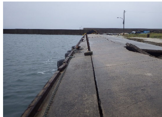
物揚場の傾斜
