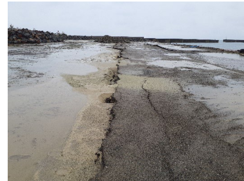
物揚場背後の沈下
