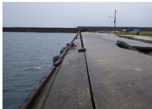
物揚場の傾斜
