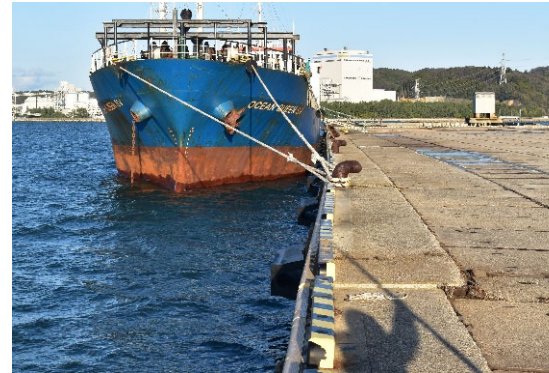
岸壁法線のずれ
