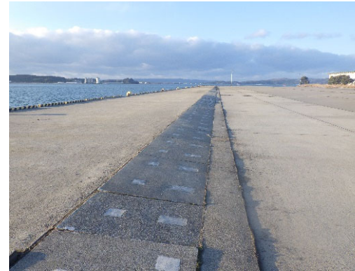
栈橋上部の前傾
