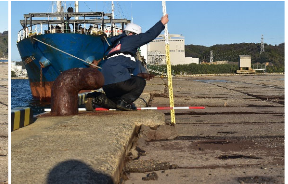
上部工背後の段差
