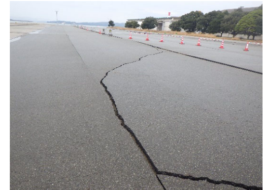
栈橋背後のクラック
