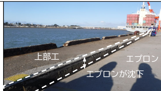
液状化によるエプロンの沈下
