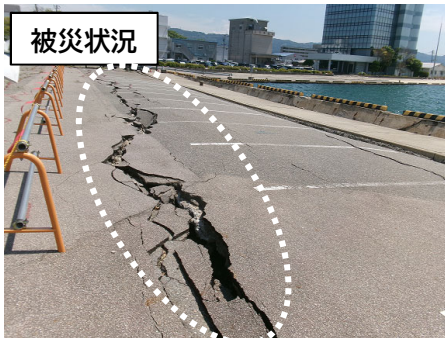
背後のひび割れ（第一西岸壁(-5.5m)）
