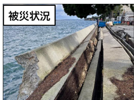
護岸崩壊及び傾斜
