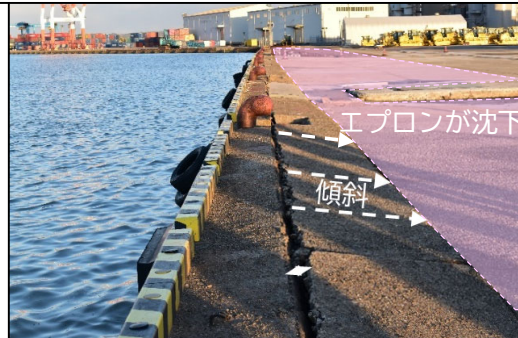
岸壁が変位し上部工にクラック
