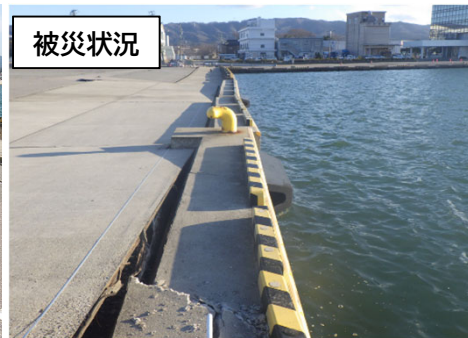
法線のはらみ出し
