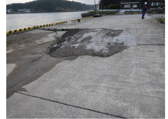
物揚場背後の沈下
