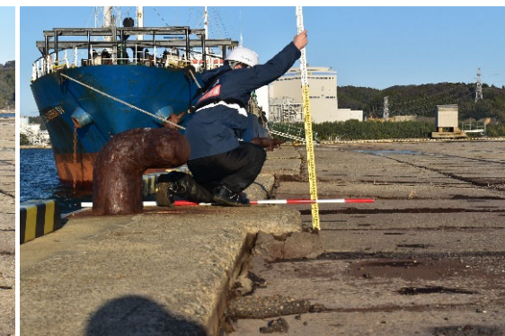
上部工背後の段差
